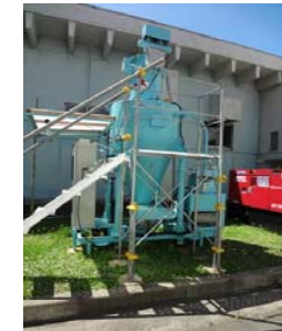
仮設の粉末活性炭注入設備
